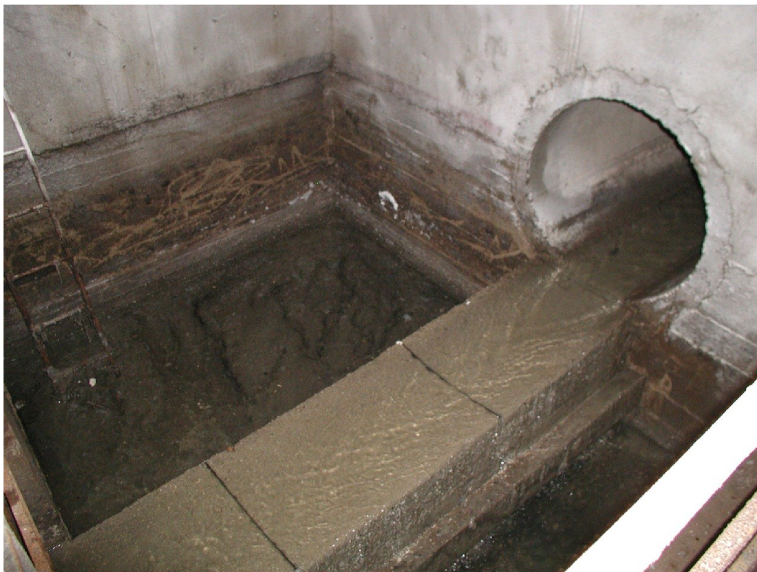
Obr. 11.2 Odlehčovací komora na přítoku do ČOV [51]
