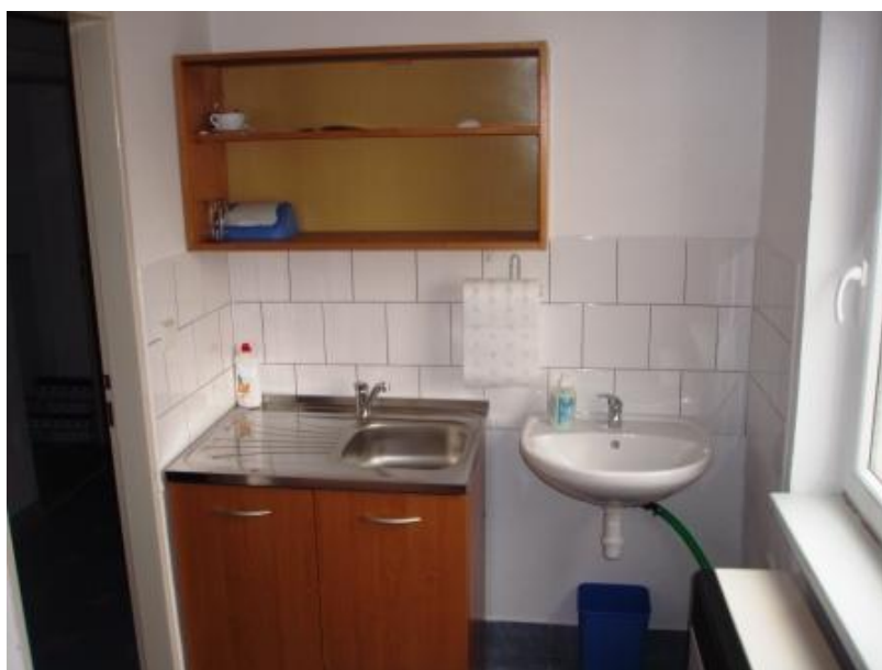
Obr. č. 22 Šatna pro personál – dřez pro mytí osobního nádobí, umyvadlo (kuchyně ZŠ)
