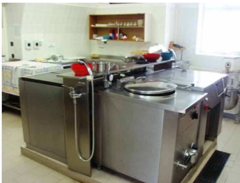
Obr. č. 25 Varný kotel a elektrická pánev (kuchyně DD)
