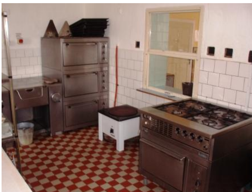
Obr. č. 10 Elektrická třítrubová pec, elektrická smažicí pánev (kuchyně ZŠ)
