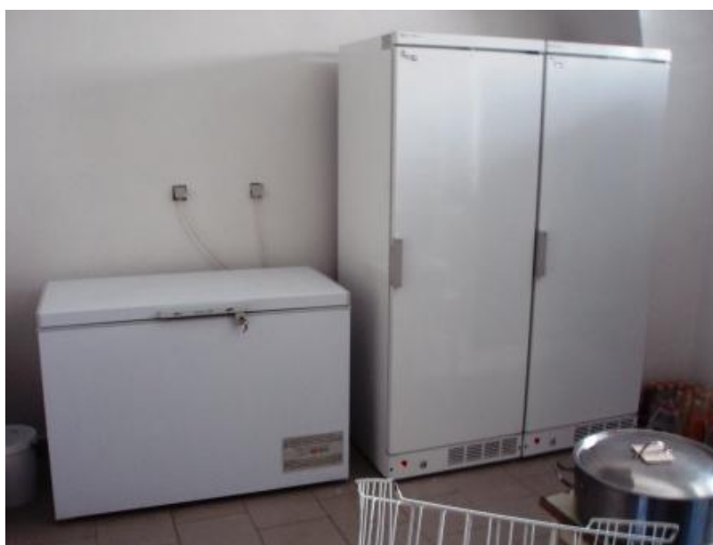
Obr. č. 32 Sklad potravin – mrazící úsek (kuchyně DD)
