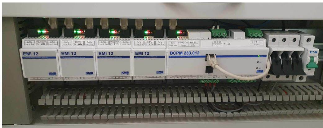
Obr. 3.2: Nainstalované měření budovy T8
