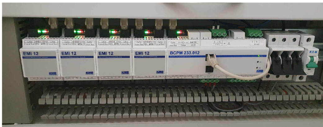
Obr. 3.2: Nainstalované měření budovy T8
