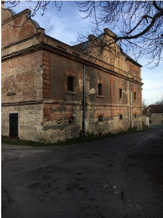
Obr. č. 3: Příklad zchátralé budovy – bývalý pivovar v Buštěhradě
