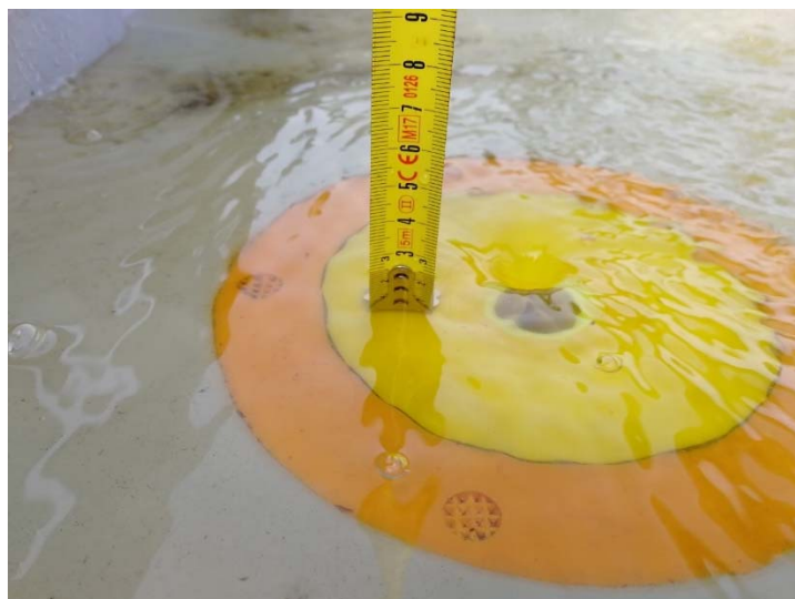
Obr. 35 – Zahlčený střešní vtok 25 mm (zdroj: archiv autora)
