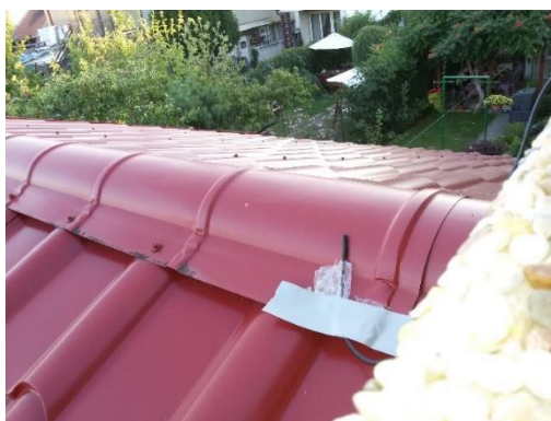
Obr. 4.90 - Umístění teplotního čidla na plechové krytině sousedního objektu
