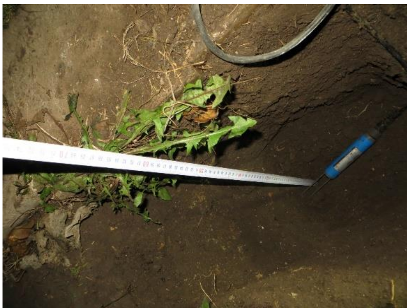
Obr. 4.62- Umístění sondy v hloubce 60 cm na intenzivní vegetační střeše
