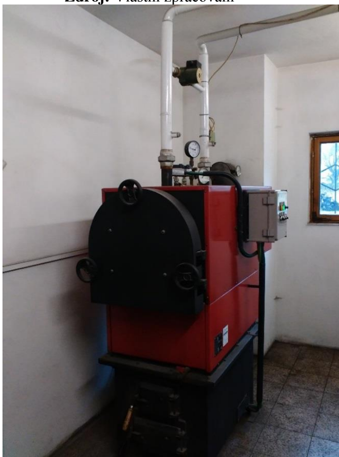
Fotografie č. 7 Kotel na spalování dřevní štěpky na obecním úřadě v obci Gruna Zdroj: Vlastní zpracování
