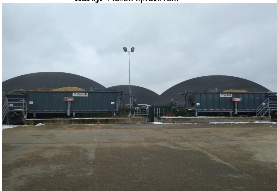
Fotografie č. 5 Fermentory a dofermentor na bioplynové stanici Kunčina II. Zdroj: Vlastní zpracování
