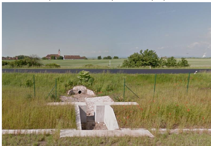
Obr. č. 39: Špatné ukončení oplocení na propustku v km 1,950
