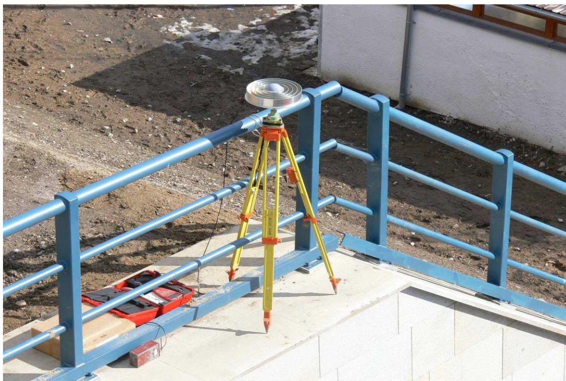
Obr. 5 Referenční stanice GNSS na bodě TARS
