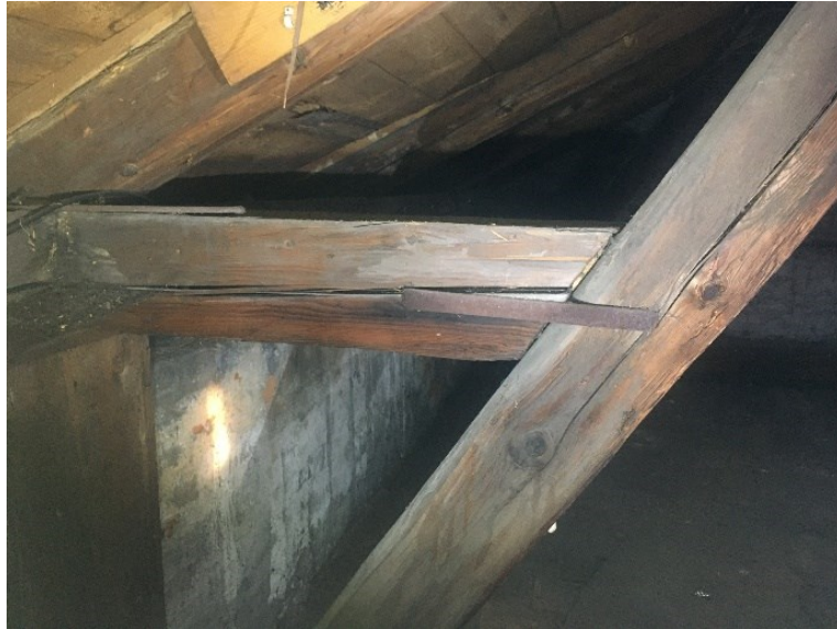
Obrázek 36: Východní část vazby; nefunkční kramle v trhlině
