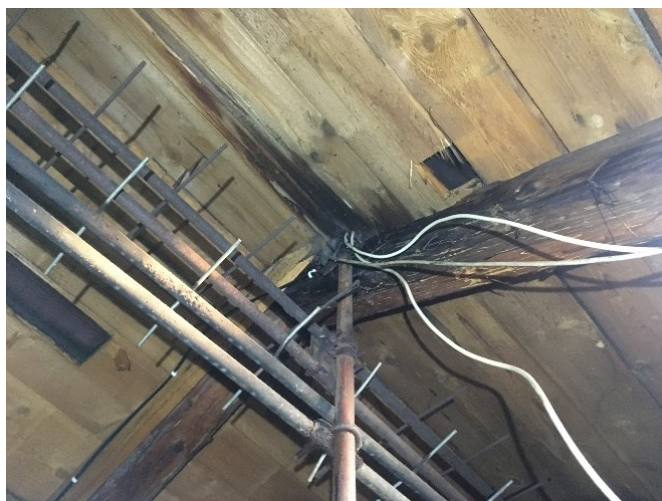
Obrázek 38: Zatékání do konstrukce
