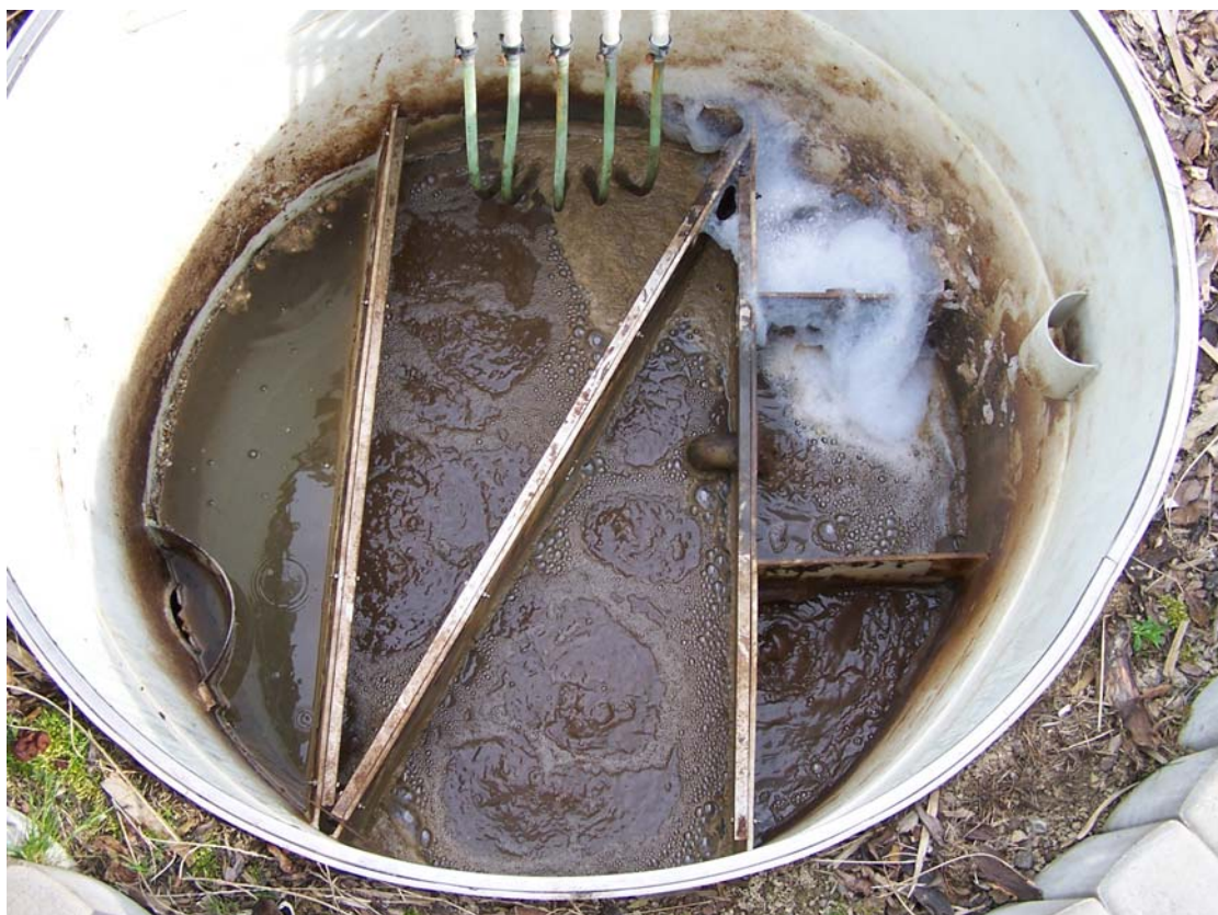
Obr. 3.2 Provozdušňování DČOV [zdroj Sakáčová dne 16. 4. 2016]
