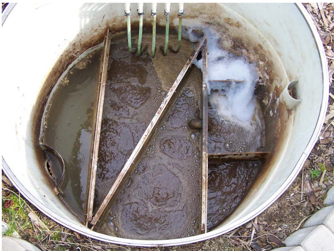
Obr. 3.2 Provzdušňování DČOV [zdroj Sakáčová dne 16. 4. 2016]
