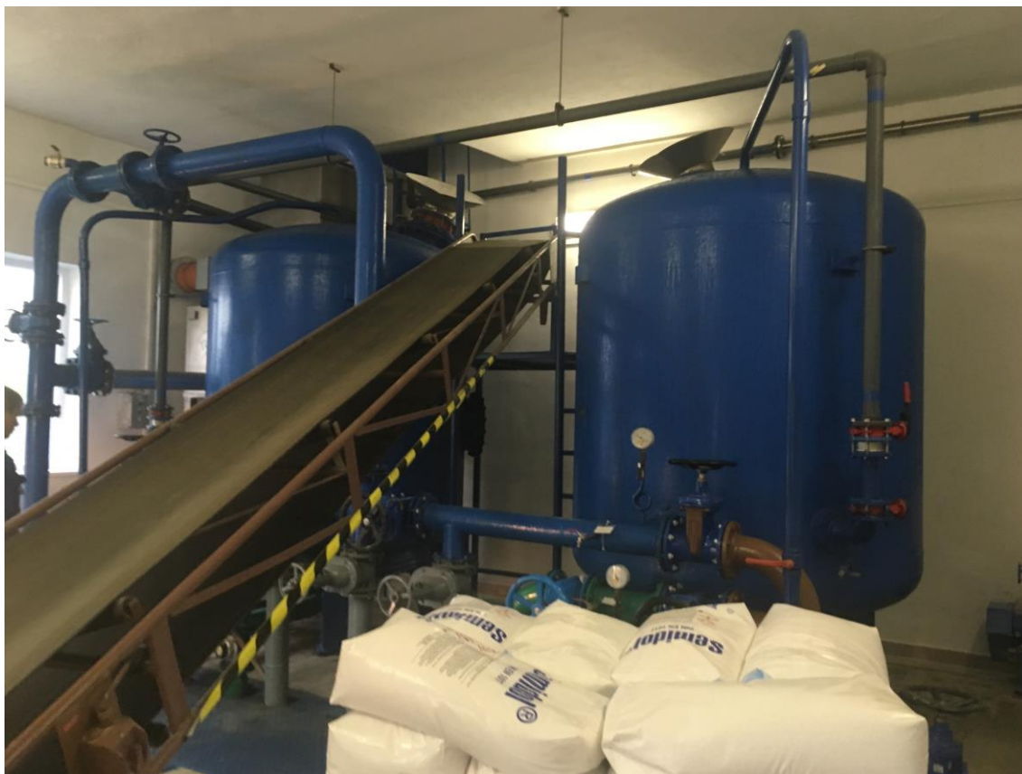
Obr. 4.3 Úpravna vody Velký Beranov
