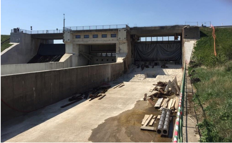
Obrázek 43: Probíhající práce na jednom z krajních polí bezpečnostního přelivu (autor Jan Gráf)
