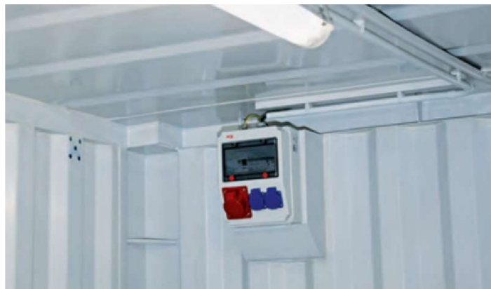
Obr. 2.2 Rozvaděč se zásuvkami [6]
