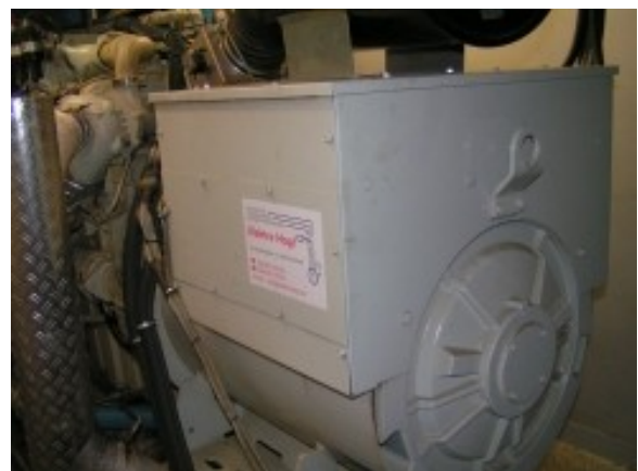
Obr. 9 – Pohled na generátor ve strojovně
