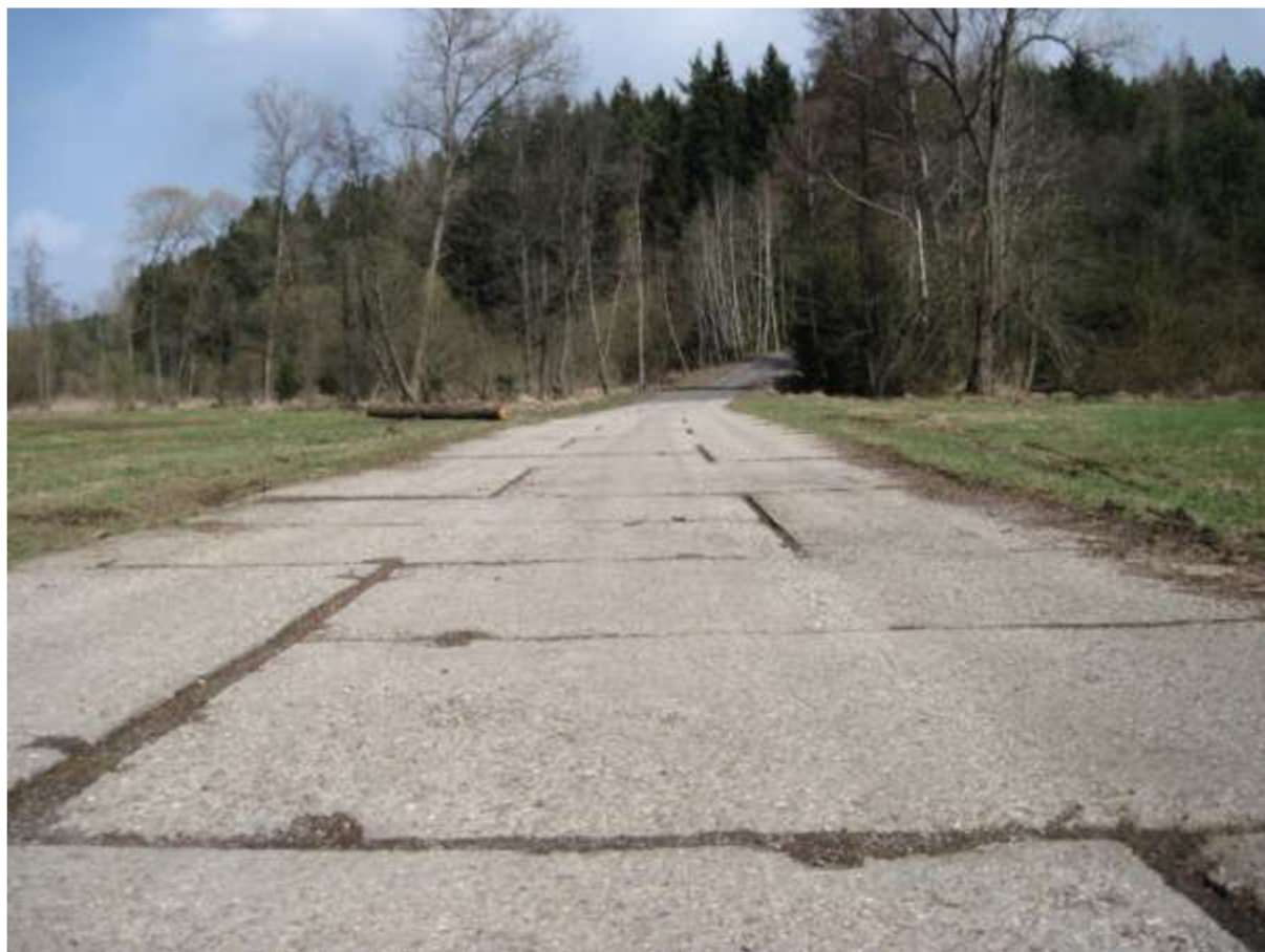
Obrázek 14 – Panelová vozovka v záplavové oblasti
