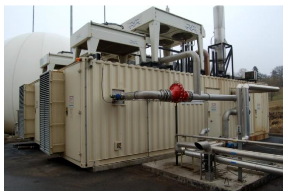
Obr. 4.7: Kogenerační jednotky [zdroj autor]
