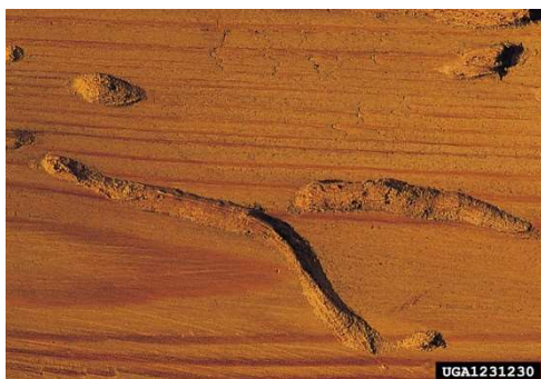
Obrázek 6 Technické poškození dřeva (Zdroj: Gyorgy Csoka, Hungary Forest Research Institute, Bugwood.org)
