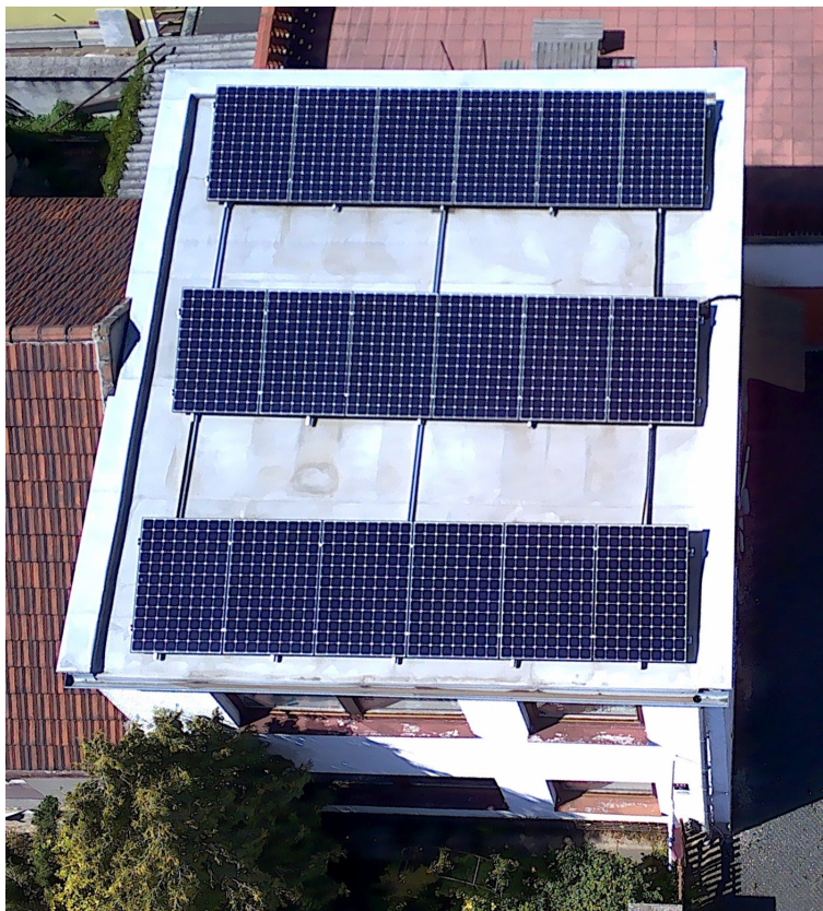
Obrázek 3.3. Fotovoltaické panely na střechě domu
