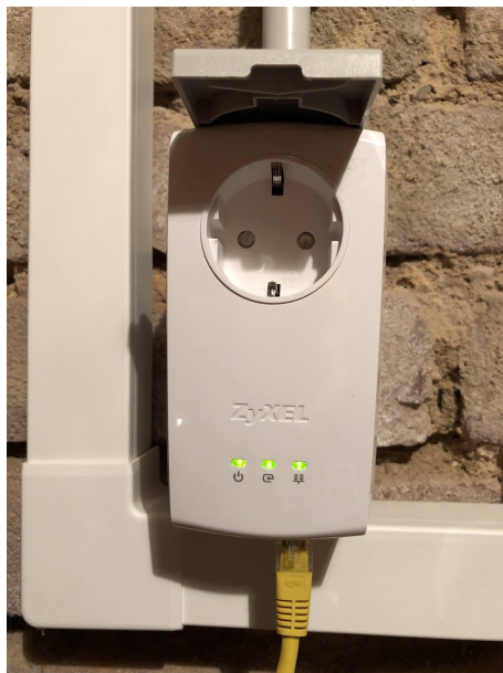
Obrázek 3.6. ZyXEL PowerLine Ethernet u střídače Fronius
