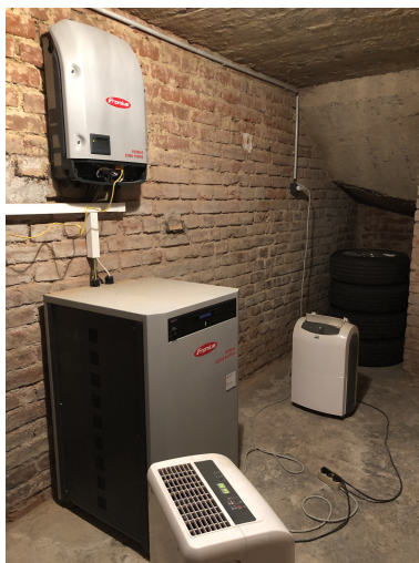
Obrázek 3.10. Střídač, akumulátory a odvlhčovače ve sklepě
