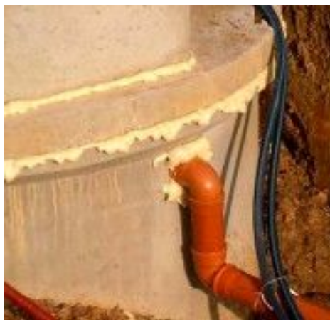
Obr. 18 Těsnění trubky v betonové nádrži [1]
