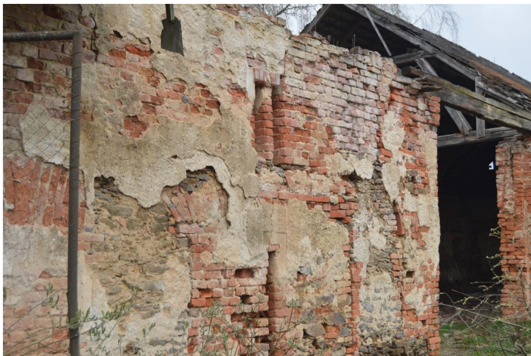
Foto č. 11 – Ukázka další nevyhovující zdi, určené ke zbourání (zdroj: vlastní)
