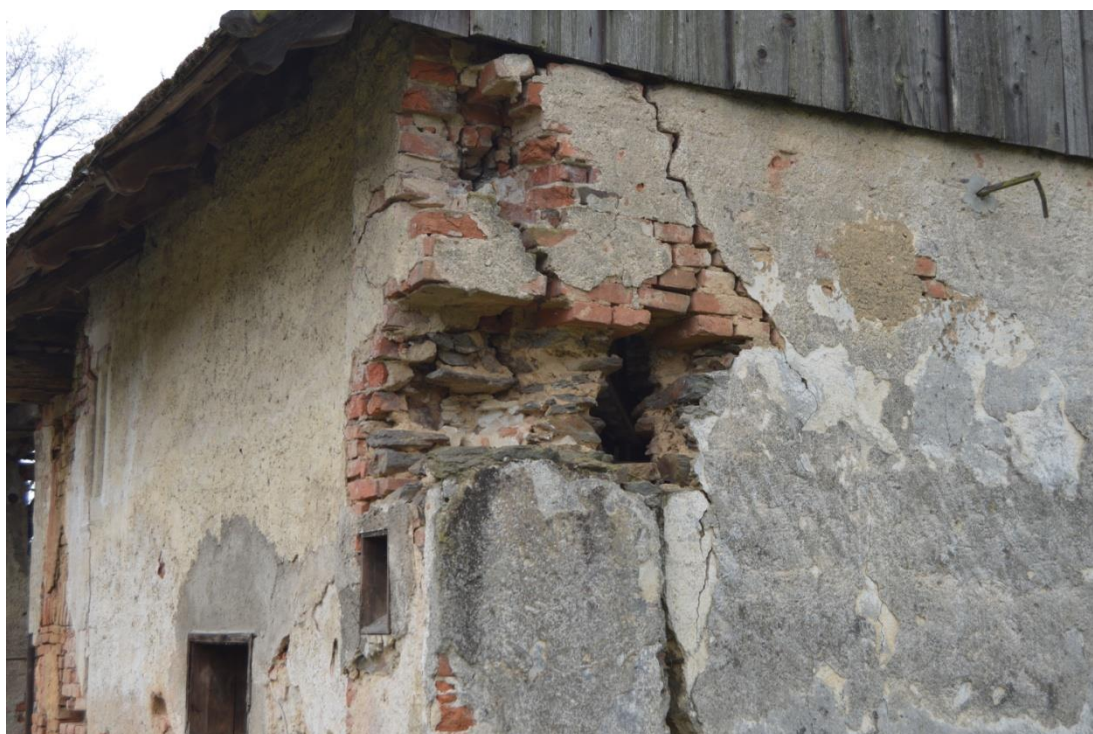
Foto č. 10 – Ukázka praskliny zdi, vyhodnocené jako nevyhovující (zdroj: vlastní)
