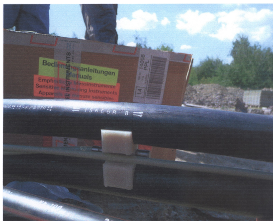
Obr. 13 Způsob umístění čidel mezi jednotlivé větve HDPE potrubí
