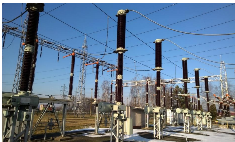
Obr. 5.1 Vypínač AEG S1-245 rozvodňa R220kV.
