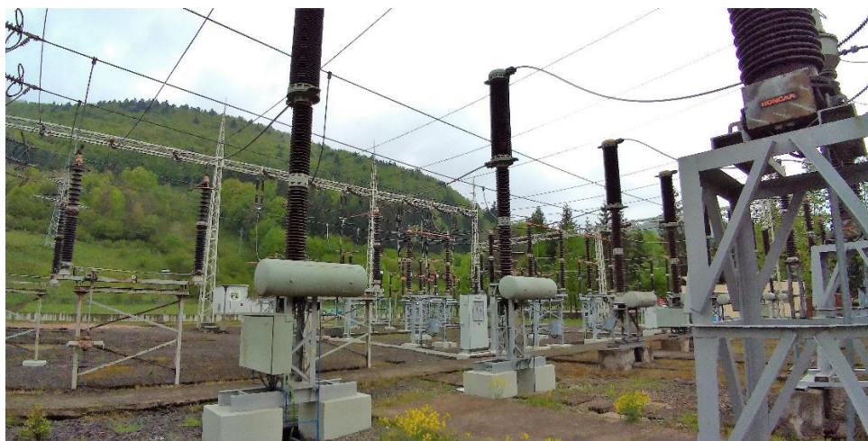
Obr. 9.1 Vypínač S1-245 v rozvodni R220kV.
