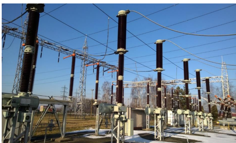
Obr. 5.1 Vypínač AEG S1-245 rozvodňa R220kV.
