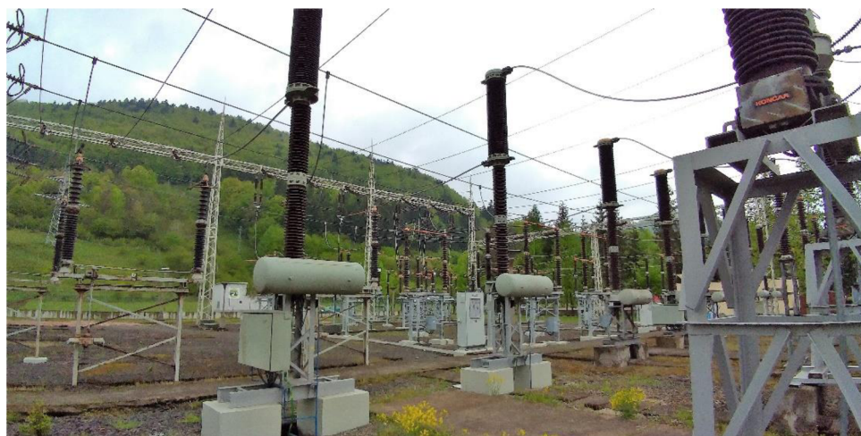
Obr. 9.1 Vypínač S1-245 v rozvodni R220kV.
