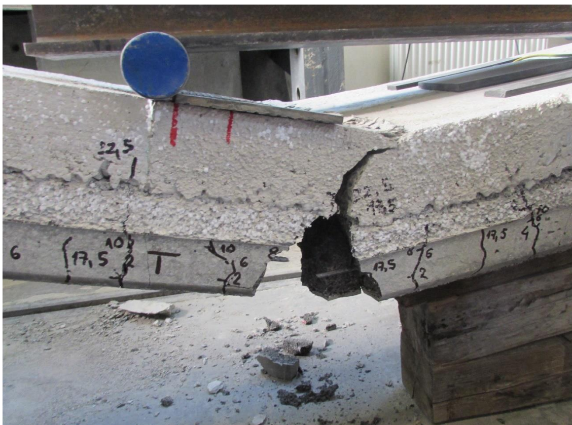
Obr. 105: Typické porušení filigránového nosníku
