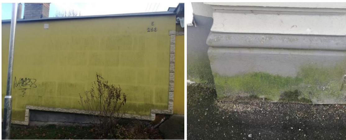
Obrázek 1: Ukázky napadení náchylných částí fasád řasami. Budovy v Liberci.
