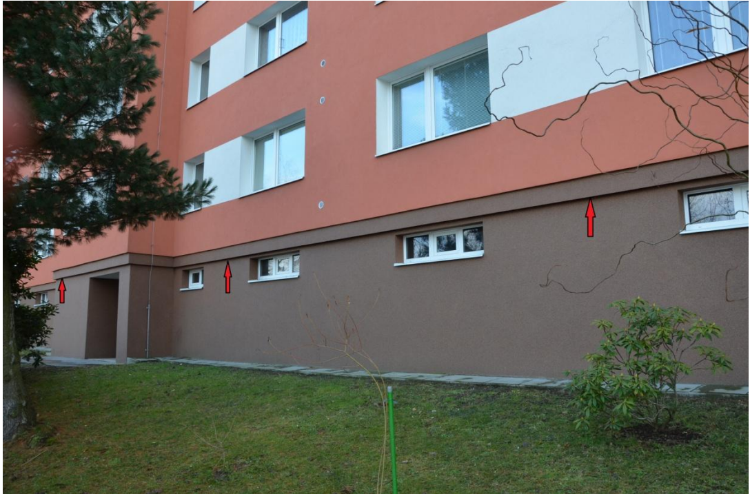
Foto č. 27: Sídliště Broumovská – spára lemující celou severní stranu domu
