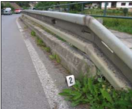
Obr. č. 32 - Poškozený obrubník od pravého předního kola[16]
