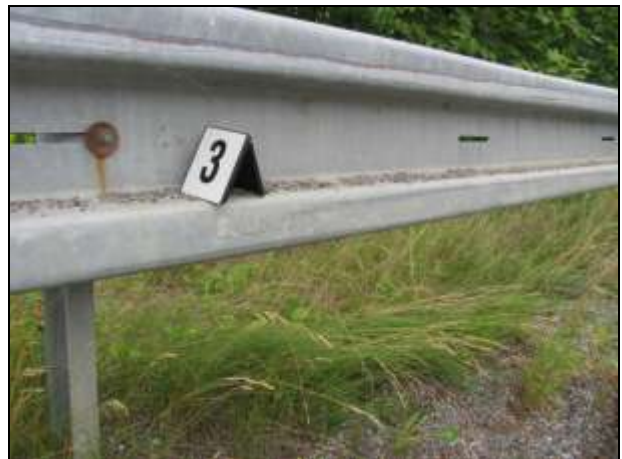
Obr. č. 33 - Poškozené svodidlo od nárazu vozidla levou přední částí[16]
