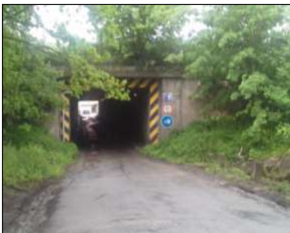
Obr. č. 7 - Nebezpečný podjezd železniční trati [vlastní zdroj]
