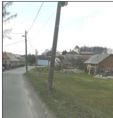
Obr. č. 16 - Nechráněné sloupy v obci [vlastní zdroj]
