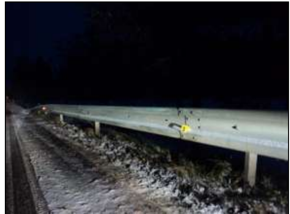
Obr. č. 102 - Poškozená svodidla[16]
