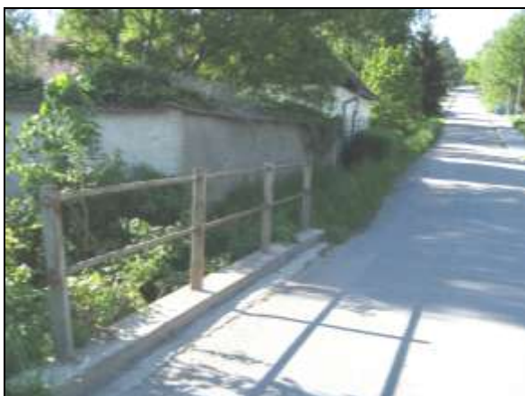
Obr. č. 9 - Zastaralá zábradelní konstrukce [vlastní zdroj]
