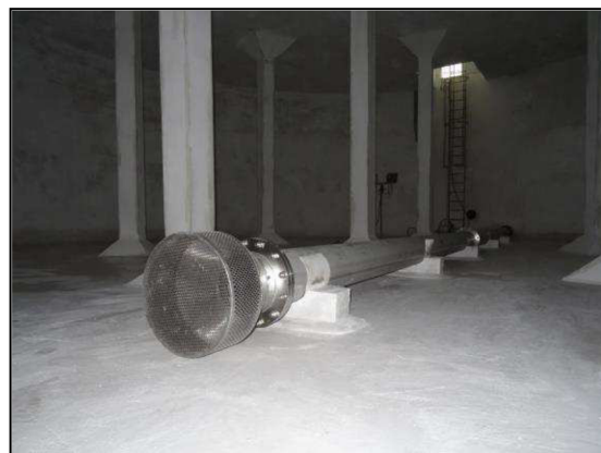
Obr. 8.26 Pohled na sací koš nerezového odběrného potrubí DN400.
