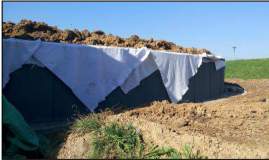
Obr. 8.20 Pravá AN (tou dobou už zprovozněná) je téměř zasypána. V této fázi ještě zbývá tepelná izolace stěn, drenáž a pak dosypat.
