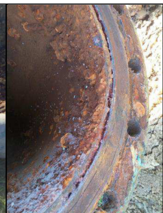
Obr. 8.24 Pokročilá koroze na vnitřní straně původního potrubí.
