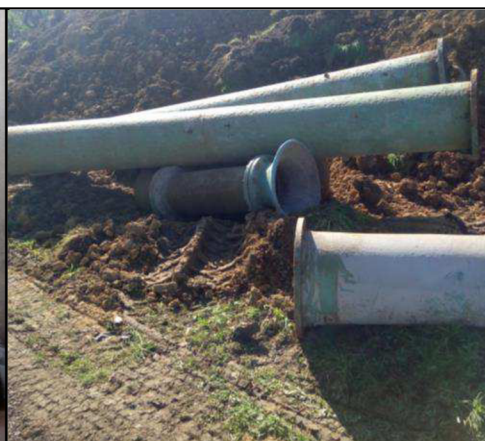
Obr. 8.23 Zkorodovaná ocelová potrubí prozatím ponechaná v prostoru staveniště.
