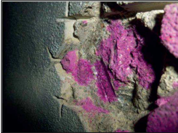
Obr. 3.2 Příklad zkoušky karbonatace fenolftaleinem in situ. [1]
