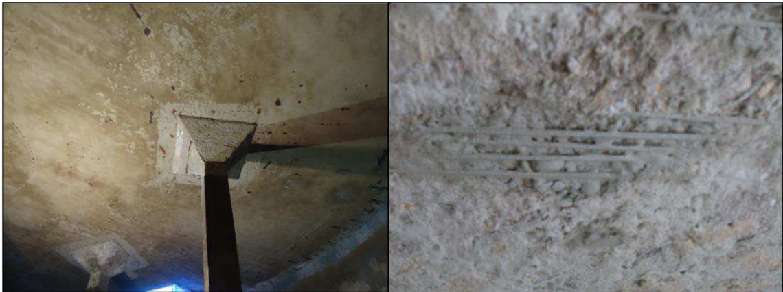
Obr. 8.6 Stropní konstrukce pravé AN - stav před rekonstrukcí. Jsou patrné známky degradace betonu.
