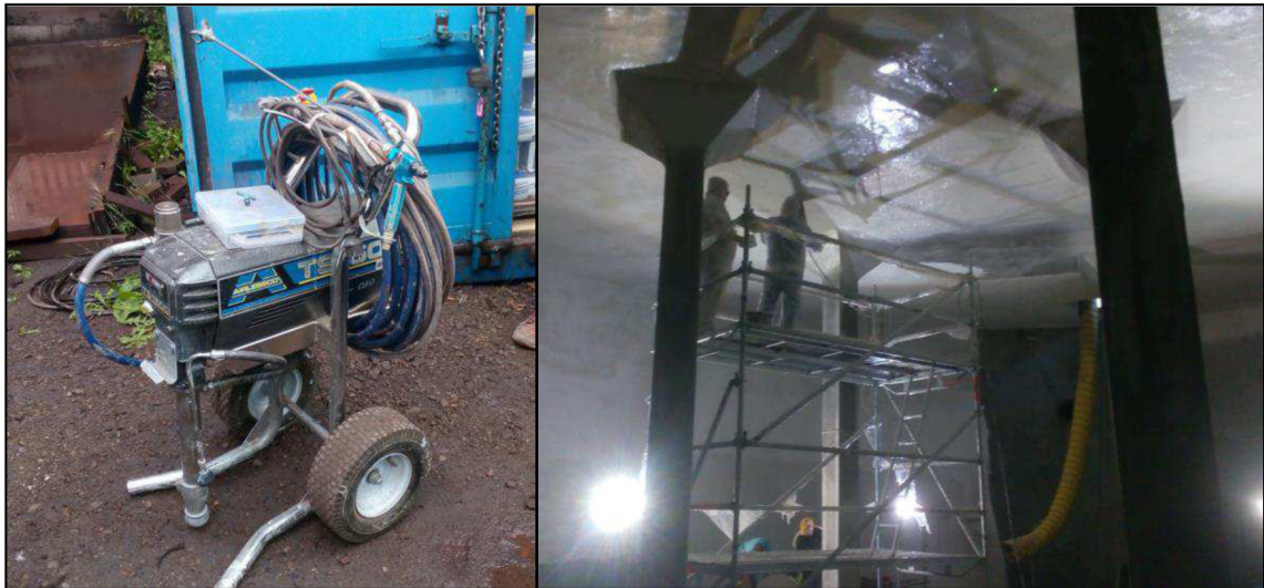
Obr. 8.14 Vlevo vysoce výkonné stříkácí zařízení AIRLESSCO TS1500 především pro aplikaci stěrkových hmot a barev. Vpravo jeho použití při strojním nanášení stěrky PCI Barraseal 2K (Masterseal 550).
