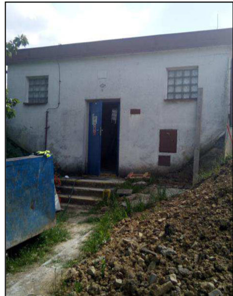
Obr. 8.5 Vstup do MK, stav před rekonstrukcí.
