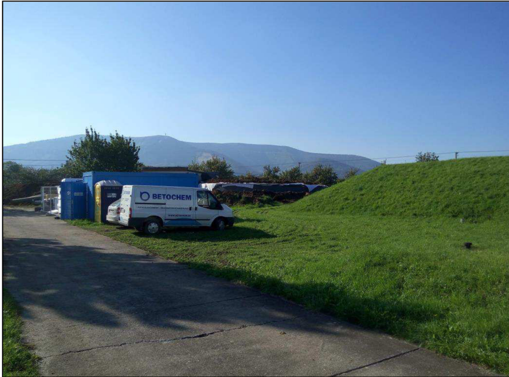
Obr. 8.3 Okolí objektu VDJ Nebory. Vlevo na obrázku technika stavební firmy provádějící rekonstrukce jak manipulační, tak obou akumulčních prostor staršího (dvoukomorového) vodojemu.
