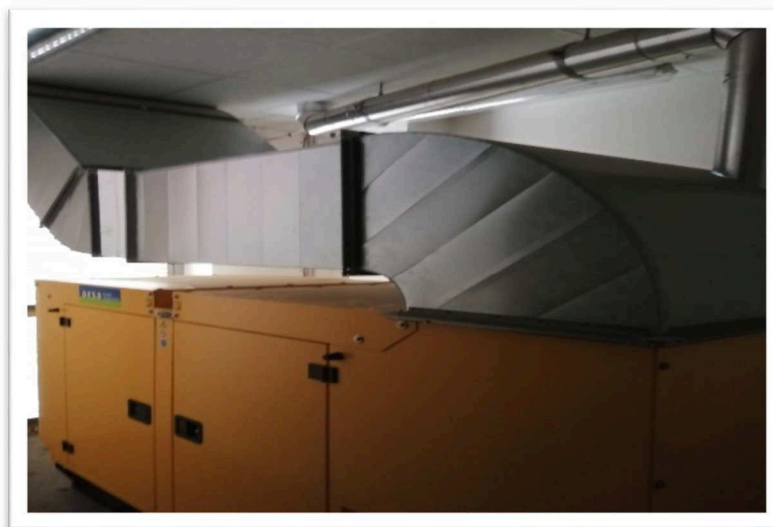
Obr. 14 - Záložní zdroj DIESEL AGREGÁT
