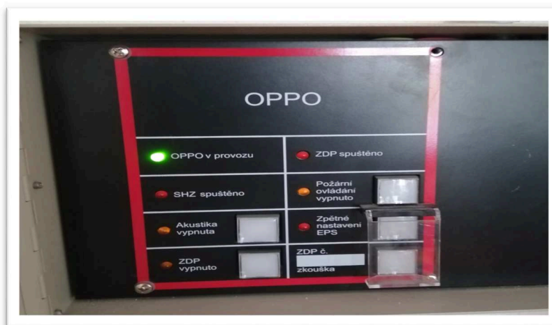
Obr. 3 – Obslužný panel požární ochrany
