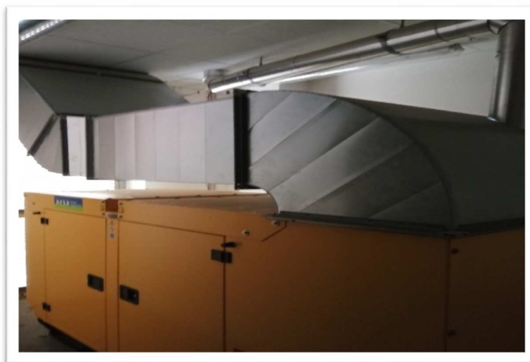
Obr. 14 - Záložní zdroj DIESEL AGREGÁT
