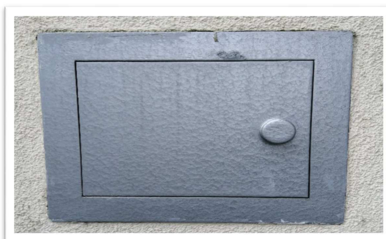
Obr. 4 – Klíčový trezor požární ochrany
