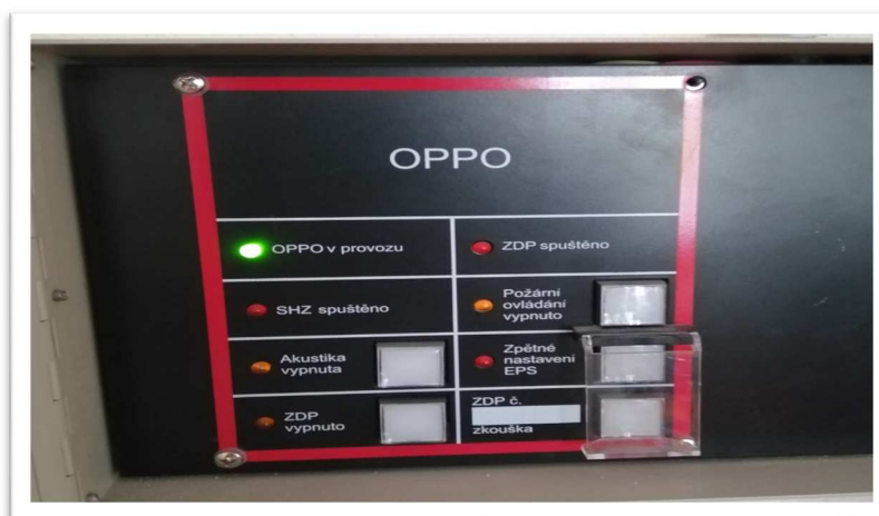
Obr. 3 – Obslužný panel požární ochrany
