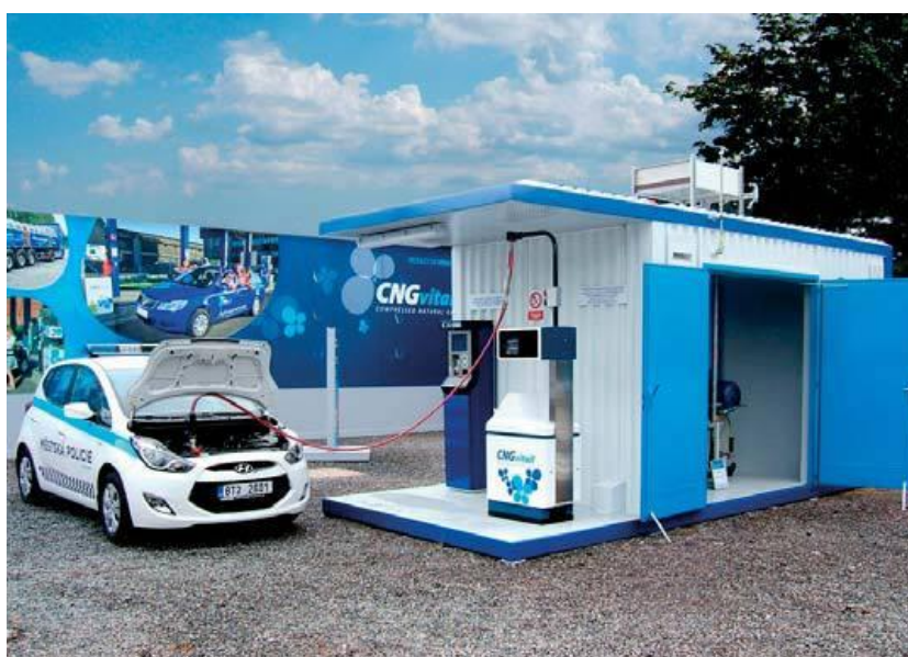
Obr. 3-4 Plnicí stanice CNG Booster
