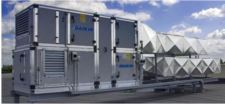
Obrázek 11 - Venkovní vzduchotechnická jednotka Daikin [13]
