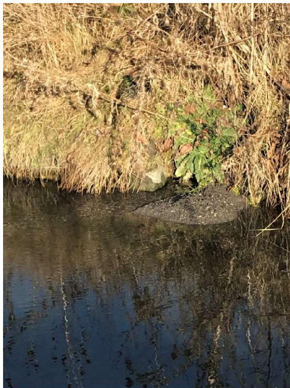
Obrázek 46 vyústění drenážní roury do Pivovarského potoka
