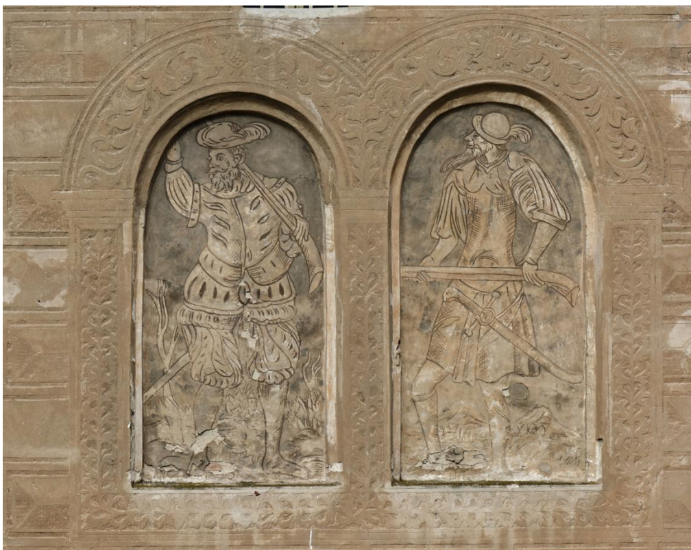
21. obr. Želiv, Trčkův hrad, východní strana, figurální sgrafito, stav před restaurováním roku 2018.
