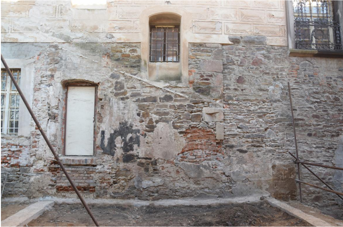
7. obr. Želiv, Trčkův hrad, detail západní fasády s odkrytými autentickými sgrafitovými psaníčky při rekonstrukci roku 2019.
