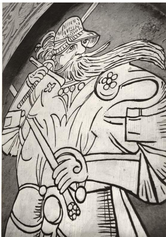
13. obr. Želiv, Trčkův hrad, jižní průčelí, sgrafitová výzdoba, stav po restaurování roku 1965.
