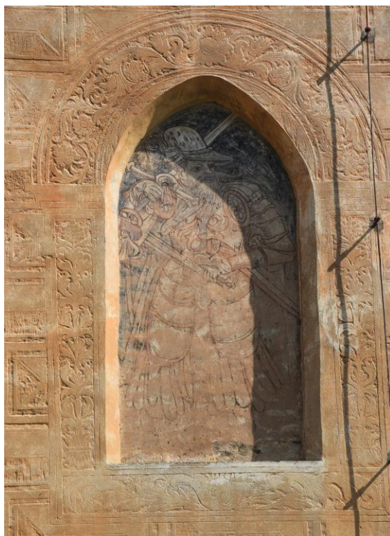
14. obr. Želiv, Trčkův hrad, jižní průčelí, sgrafitová výzdoba, stav před restaurováním roku 2018.
