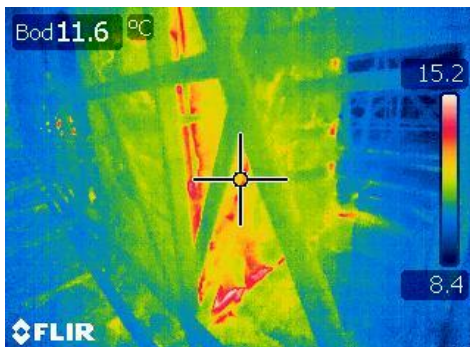
Obr. 49 Odtah vzduchotechnické jednotky v krovním prostoru při přetlaku - vykreslení vzduchové netěsnosti
