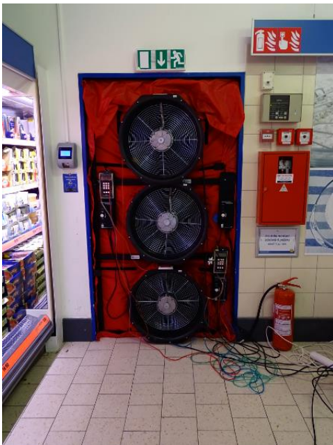
Obr. 30 Blower-door test - ventilátory 3/5 - interiér (Prodejna)
