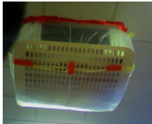
Obr. 29 Utěsnění nuceného větrání - přívodu vzduchu v prodejně
