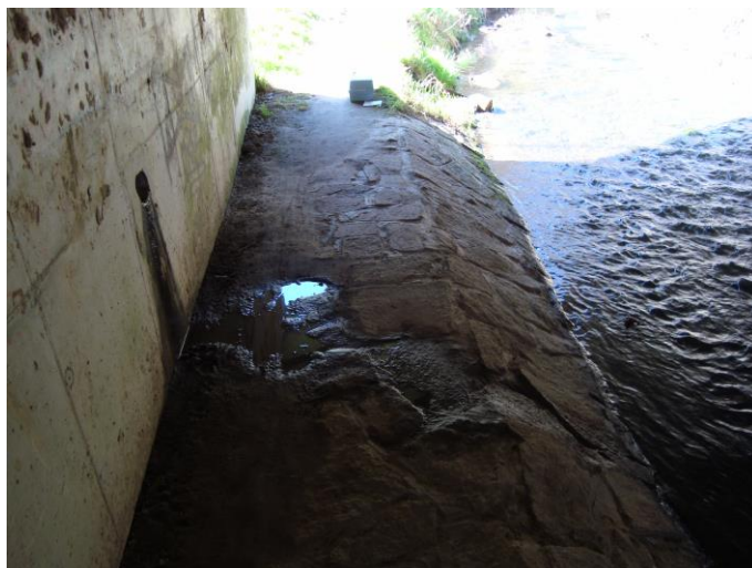
Obr. č. 18: Vyústění výpusti do koryta vodního toku Úmoří za obcí Skalice nad Svitavou (foto: Jurečková Anna)
