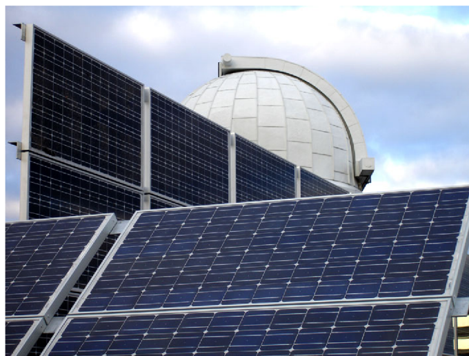
obr. 11 Dvě polohy FV panelů na ploché střeše
