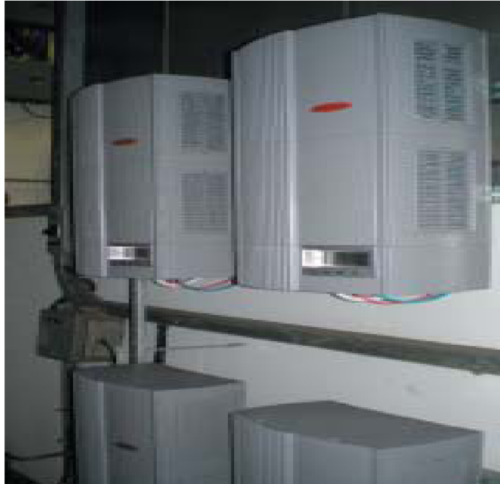
obr. 18 Umístění DC/AC-střídačů v interiéru
