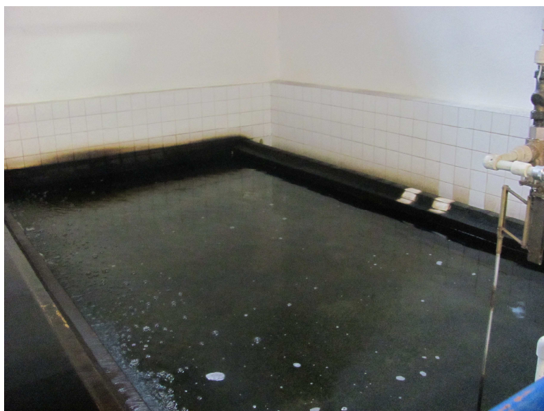
Obr. 2.16 Filtrační nádrž na úpravně vody Hamry
