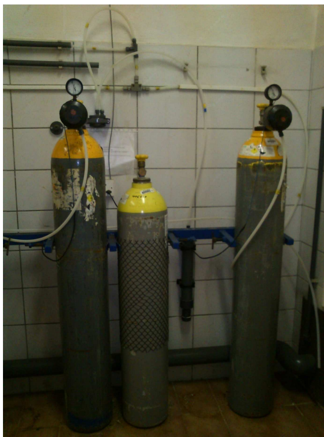
Obr. 4.25 Místnost na zpracování tlakových nádob plynného chlóru
