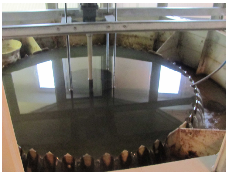
Obr. 2.3 Ocelový kónický mísič na úpravně vody Hamry
