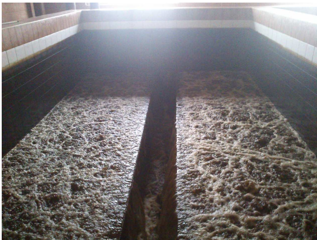
Obr. 4.21 Otevřená písková rychlofiltrace – během pracího cyklu
