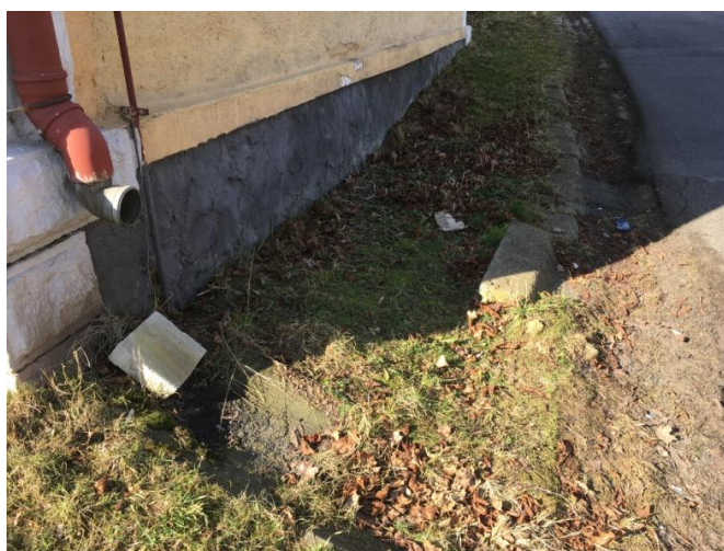
Obr. č. 19: Absence odvodu dešťové vody směrem od budovy
