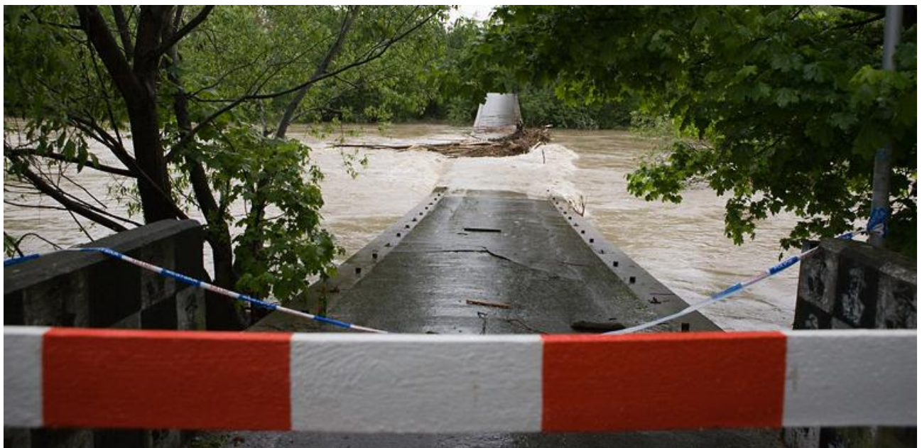
Obrázek 4. Zatopená lávka s demontovaným zábradlím u tenisových kurtů v Přerově při povodních 2010 (Přidal, 2017).
