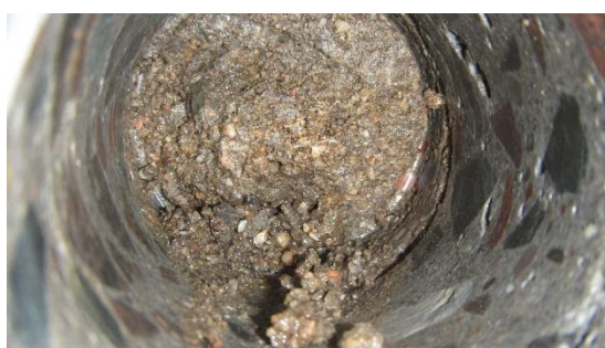
Obr. 34 – Detailní foto ostění betonu sondy V3 po vyjmutí návrtu [12]
