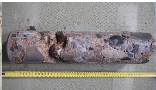
Obr. 44 – Laboratorní foto odebraného vzorku betonu ze sondy V5 [12]
