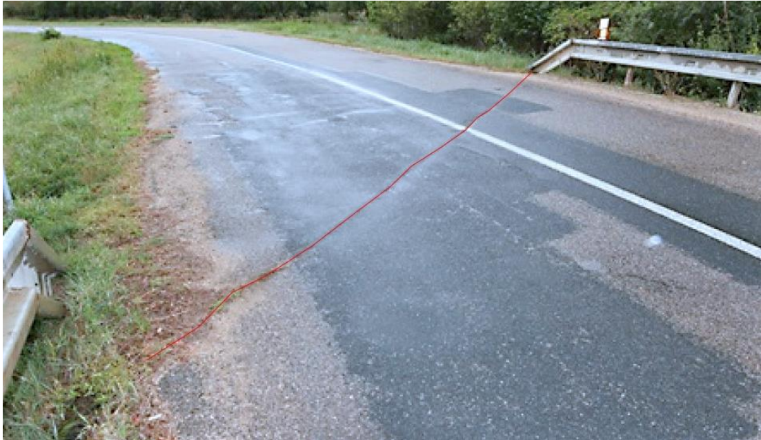
Obr. 23 – Pohled na příčnou trhlinu na vozovce [12]
