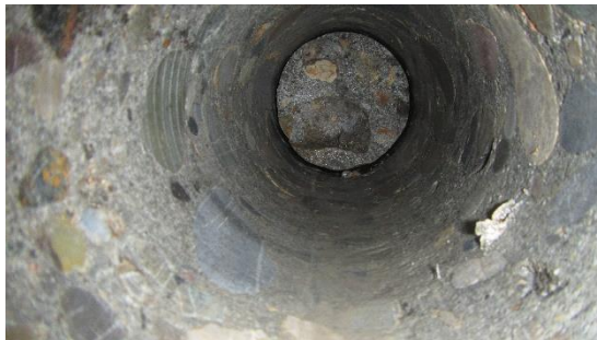
Obr. 39 – Detailní foto ostění vývrtní sondy V4 po vyjmutí návrtní [12]
