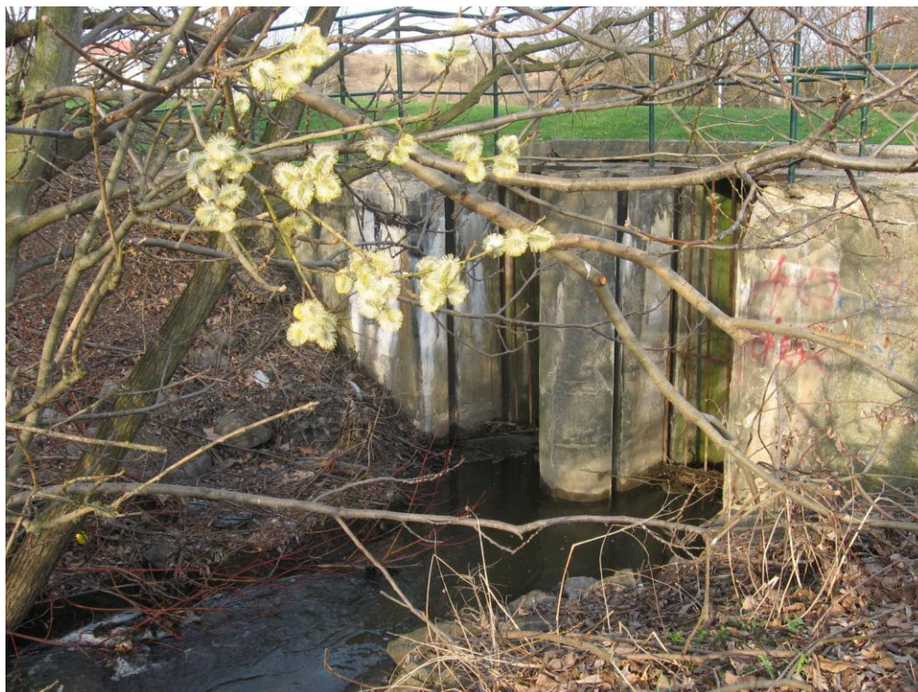
Obrázek č 6: Hrubé česle na odtoku z nádrže N1 Stodůlky
