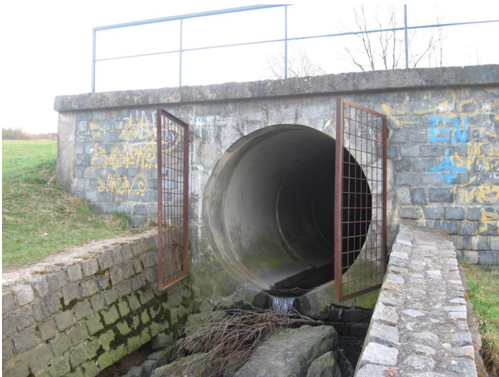
Obrázek č. 16: Kanalizační výpusť dešťové vody ze sídliště Velká Ohrada do nádrže N3 Asuán
