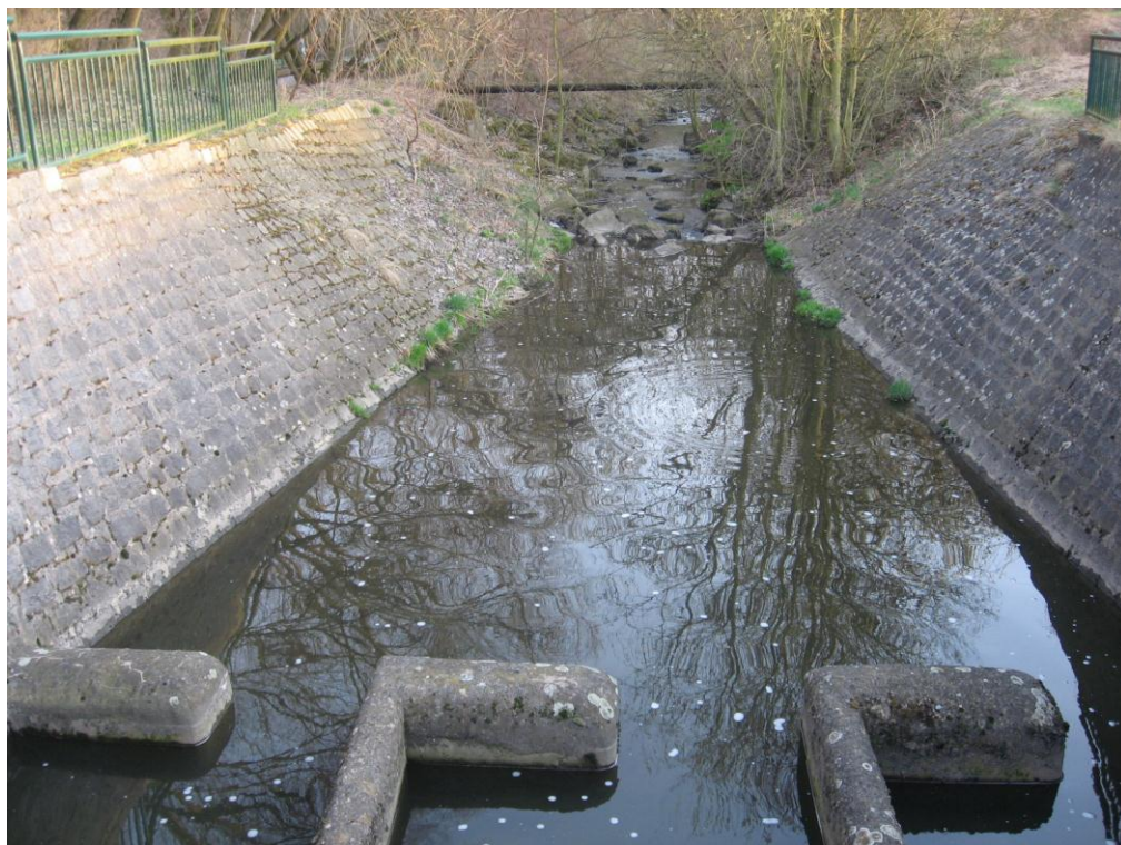
Obrázek č. 22: Výpust' z nádrže N3 Asuán
