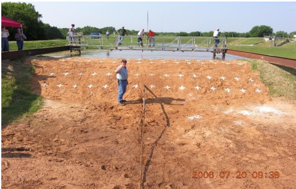
Obr. 8.16 Případová studie P1 USDA – HERU Stillwater – porušení sypané hráze v důsledku vnitřní eroze – těleso hráze (Hanson a kol., 2010)
