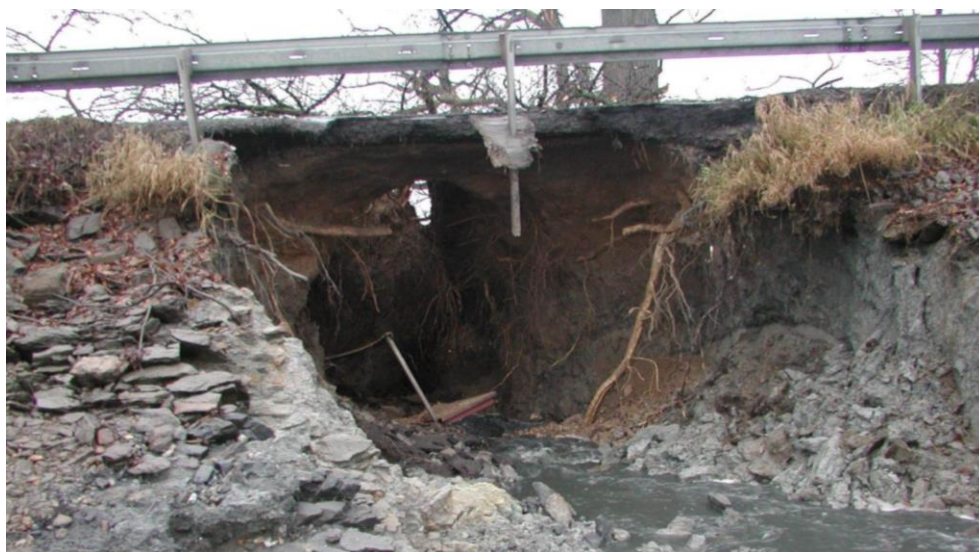
Obr. 4.21 Protržení Kočínského rybníka v roce 2002 – typický příklad vnitřní eroze podél poškozené spodní výpusti, ve stejném místě došlo na vzdušné straně také k vývratu dubu (VD-TBD, 2021)
