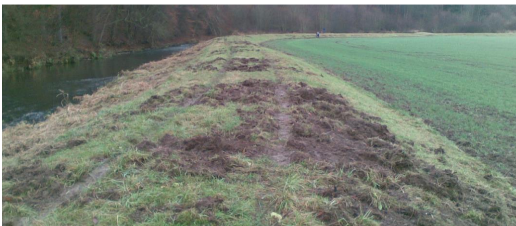
Obr. 4.16 Poškození ochranné hráze na Třebůvce – poškození hráze divokými prasaty (VD – TBD, 2021)
