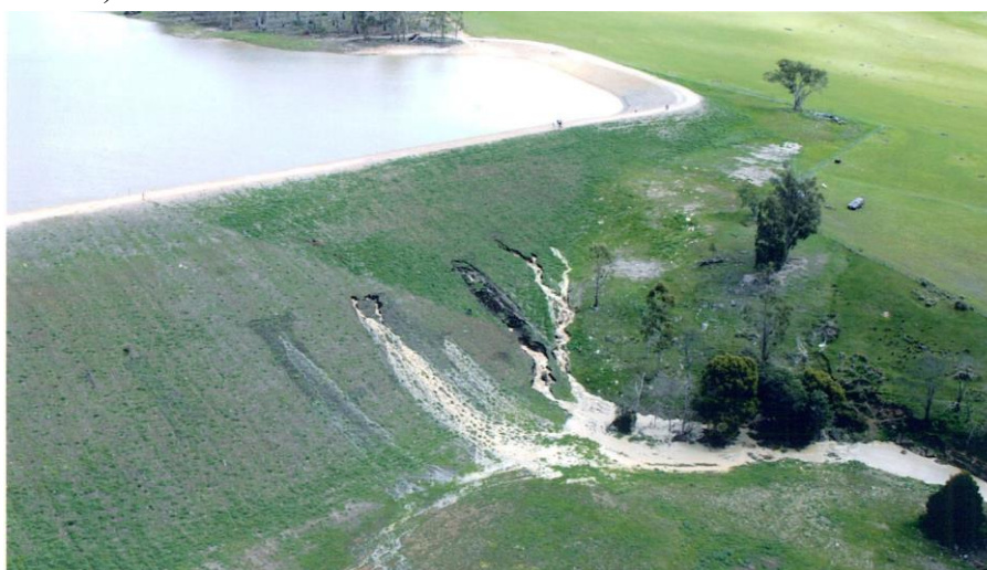
Obr. 4.4 Porucha zemní hráze VD Tunderbridge filtrační deformací (Farrar, 2008)
