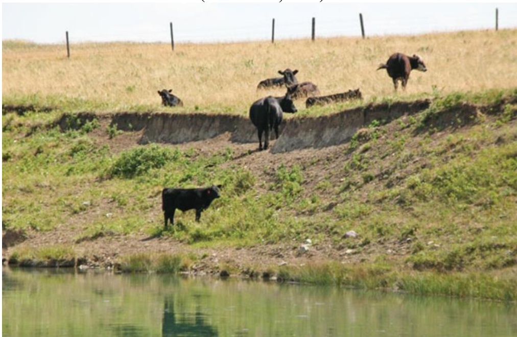
Obr. 4.17 Poškození návodní strany hráze domestikovanou zvěří (ASDSO, 2021)
