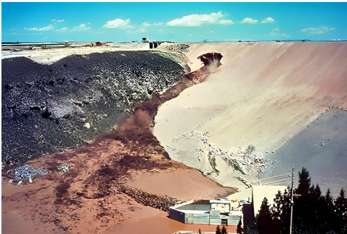
Obr. 1.2 Porucha sypané zemní hráze Teton vnitřní erozí (IPRCTDF, 1976)
