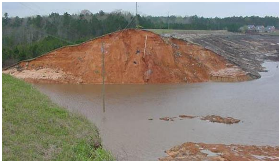
Obr. 8.38 Reálné protržení Big Bay, 2004 – pohled na profil průlomového otvoru – patrné že nebylo provedeno vnitřní těsnění dle projektu (Ferguson a kol., 2004)
