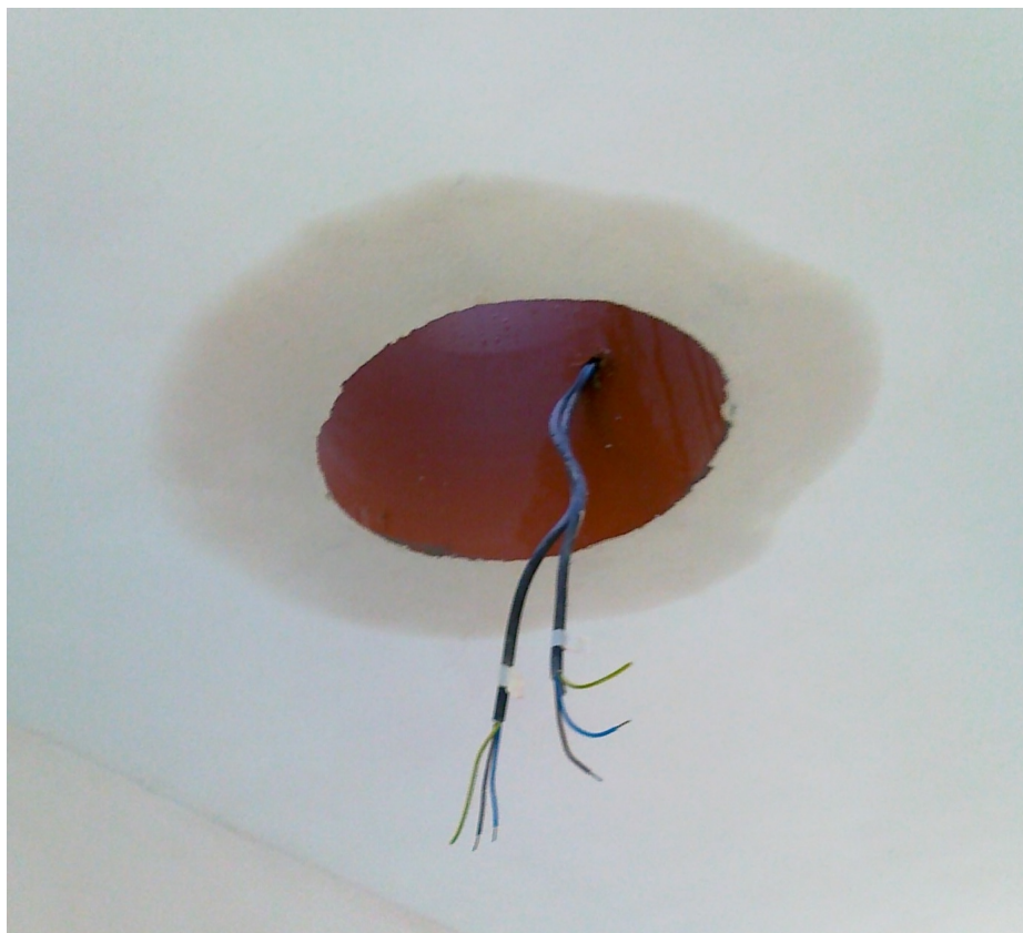
Obr. 4.25 Zatečení srážkové vody v místě světlovodu
