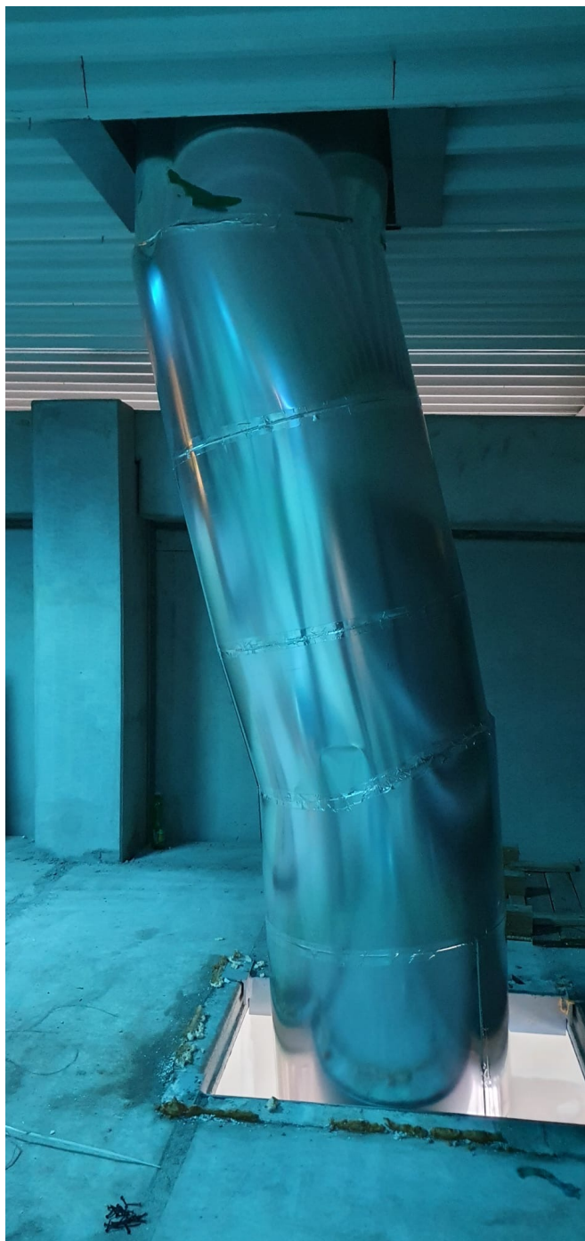
Obr. 4.26 Deformace světlovodného tubusu v místě ohybu
