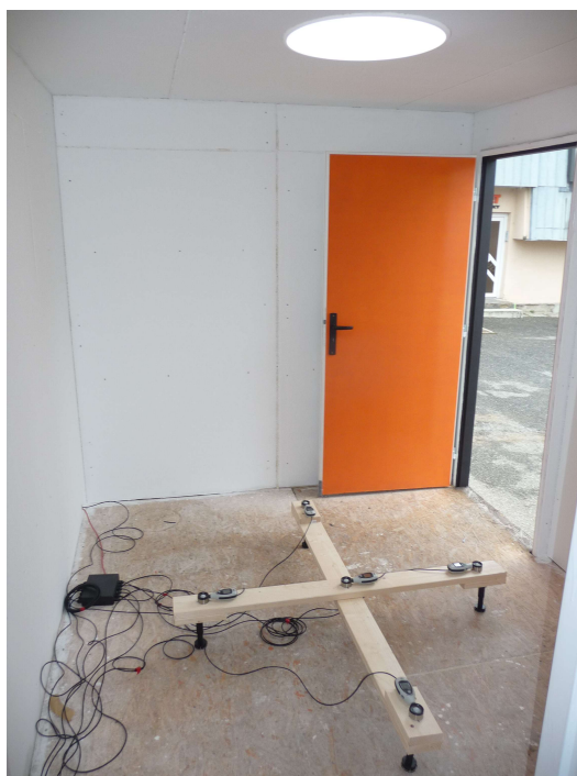
Obr. 3.4 Instalace měřicího zařízení – buňka 1 umístěná v části se vstupními dveřmi
