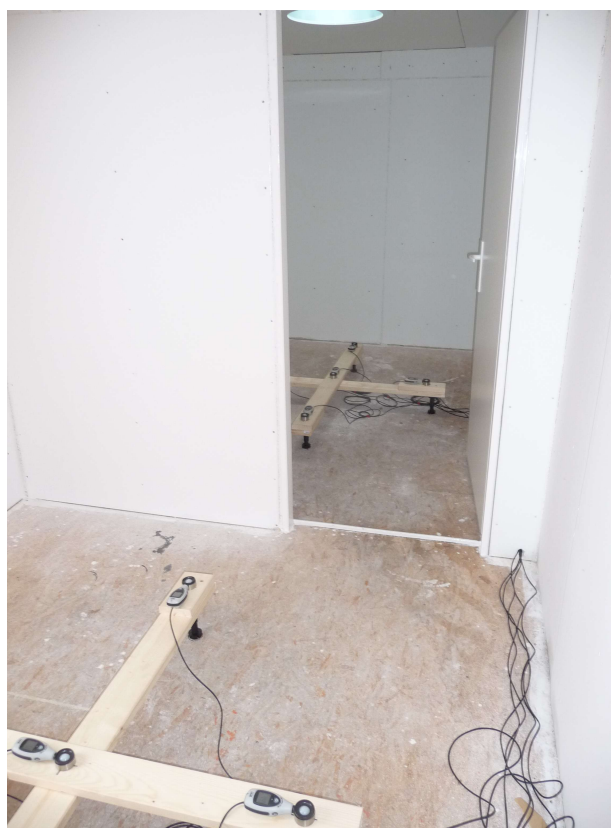
Obr. 3.5 Instalace měřicího zařízení – buňka 1 a buňka 2 odděleny vnitřní příčkou s dveřmi
