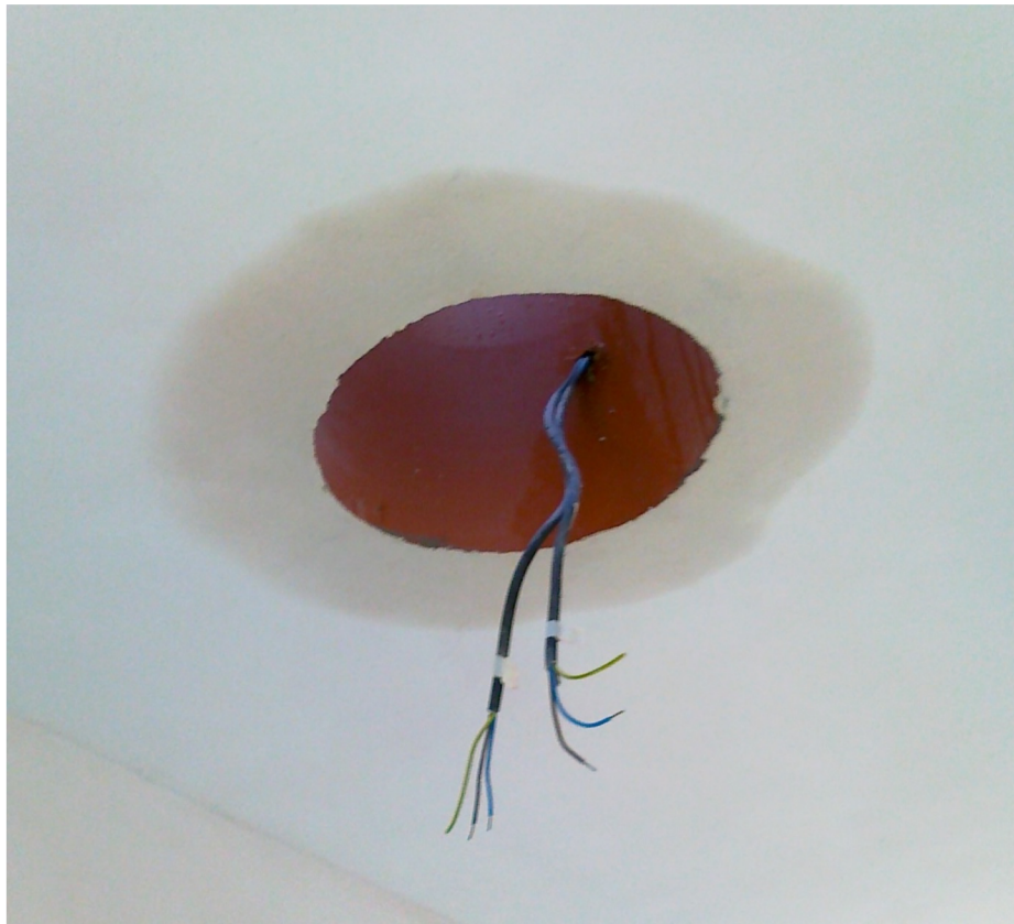
Obr. 4.25 Zatečení srážkové vody v místě světlovodu
