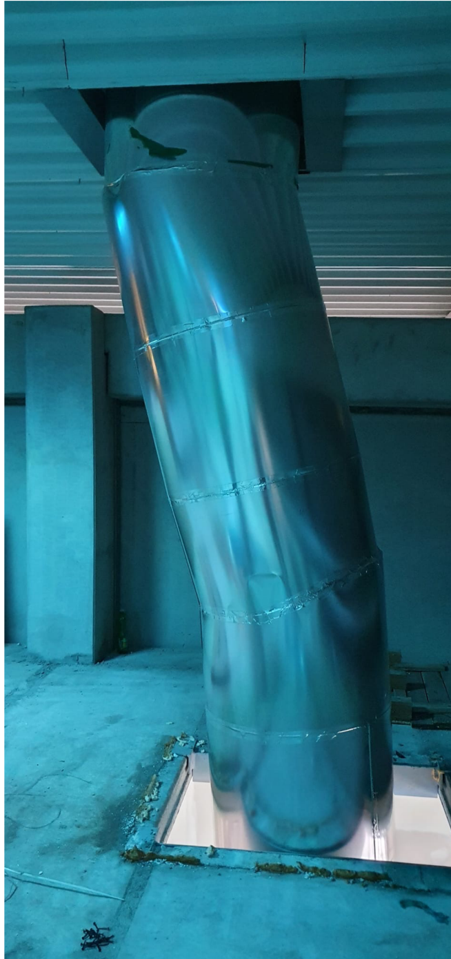
Obr. 4.26 Deformace světlovodného tubusu v místě ohybu
