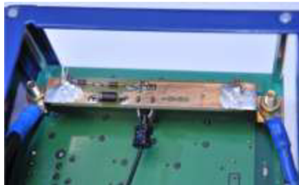
Obr. 41: Fotografie monitoru přepětí v polovičním meziobvodu
