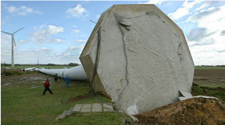
Obr. 5.10 Příklad nesprávného dimenzovania základov [43]
